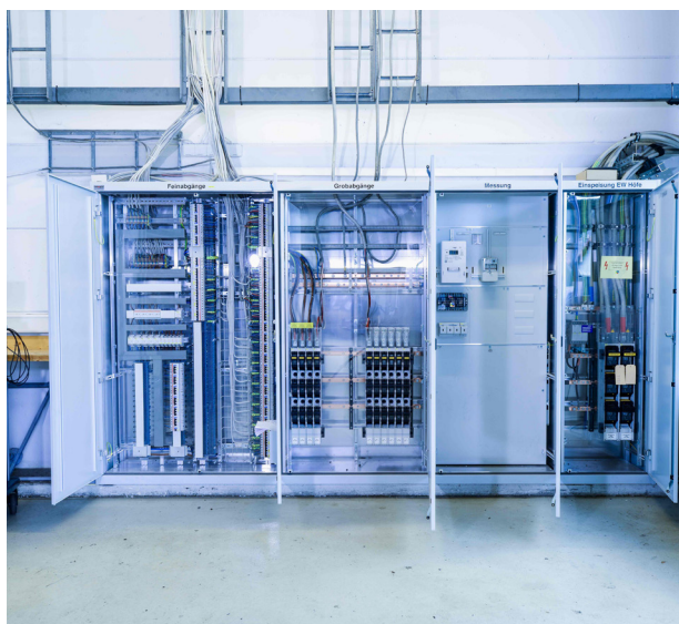
Hauptverteilung inklusive Einspeisefeld
